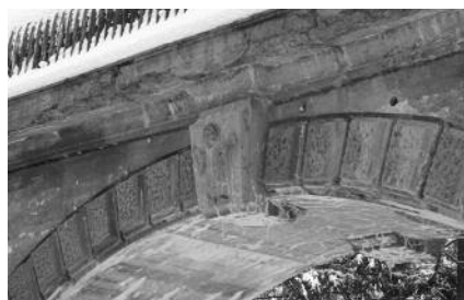
Der Zahn der Zeit hat schon kräftig an dem Bauwerk genagt. Foto: Holzer
