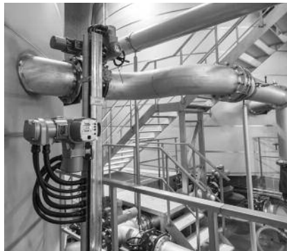
Trinkwasser-Hochbehälter Reißing Foto: waldwasser
