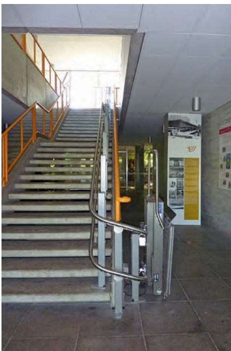
Abb. 76 Barrierefreiheit im öffentlichen Gebäude: additiver Treppenplattformlift (Foto: Bernd Vollmar)
