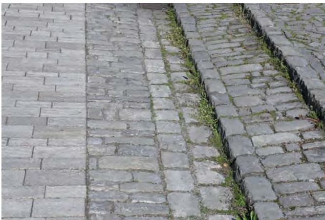
Abb. 38 Barrierefreiheit im öffentlichen Raum: weitgehend einheitliche Pflastergestaltung, jedoch unzureichend ebene (Teil-)Oberfläche im historischen Ensemble (Foto: Klaus-Jürgen Edelhäuser)
