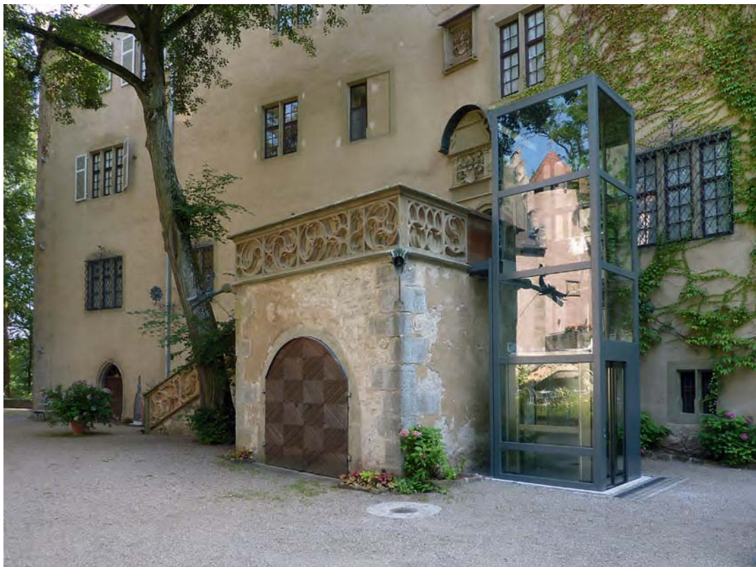
Abb. 71–73 Barrierefreiheit im museal genutzten Baudenkmal: Aufzugmodell im Maßstab 1:1 zur Veranschaulichung der Auswirkungen auf das Erscheinungsbild und Aufzug nach Fertigstellung. Eine großflächige Verglasung kann bei bestimmten Lichtverhältnissen durch Spiegelungen einen massiv wirkenden Baukörper entstehen lassen (Fotos: Klaus-Jürgen Edelhäuser)
