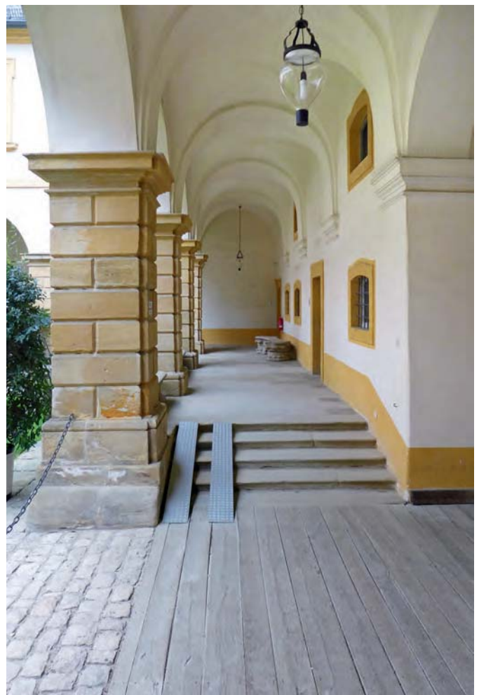
Abb. 59 Barrierefreiheit im museal genutzten Baudenkmal: Kompromisslösung mit zweiteiliger Rampe erfordert Hilfe durch ständig anwesendes Personal (Foto: Bernd Vollmar)
