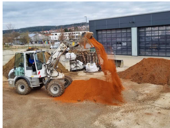
Abb. 7: Herstellung der bewachsenen Bodenzone aus dem am Standort gewonnenen Oberboden und weiteren Zuschlagstoffen
