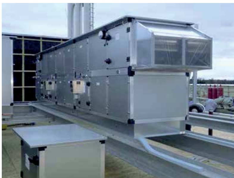
Ansicht einer Dachlüftungszentrale, Schulzentrum an der Gerastraße, München, Büro allwärme GmbH
